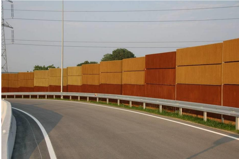
Rys. 14. Ekran przeciwhałasowy (betonowy)
