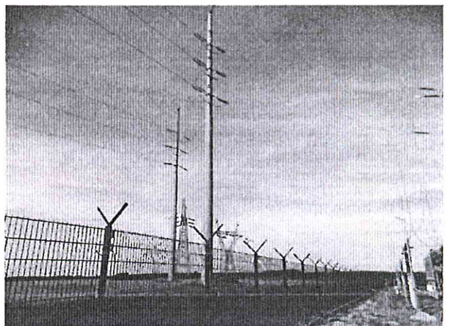
Wejście linii 220 kV do stacji Leśniów
