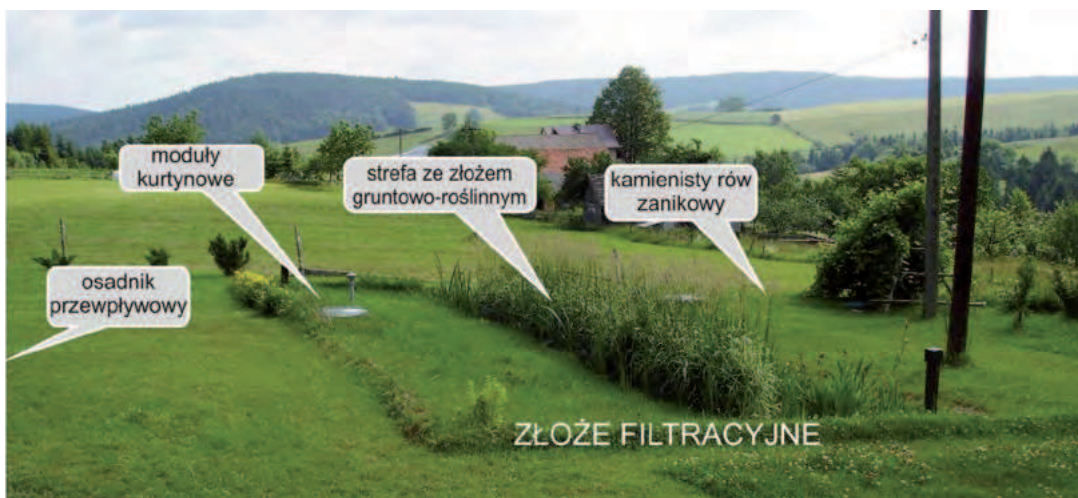
Fot. 7. Oczyszczalnia z zintegrowanym złożem filtracyjnym w gospodarstwie domowym zamieszkałym przez 5 osób
