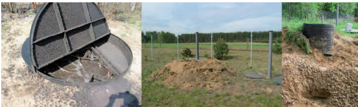
Fot. 10. Przykład oczyszczalni przydomowej z zastosowaniem metody osadu czynnego-rozwiązanie problematyczne dla indywidualnego użytkownika (zdjęcie: Wojciech Dąbrowski)
